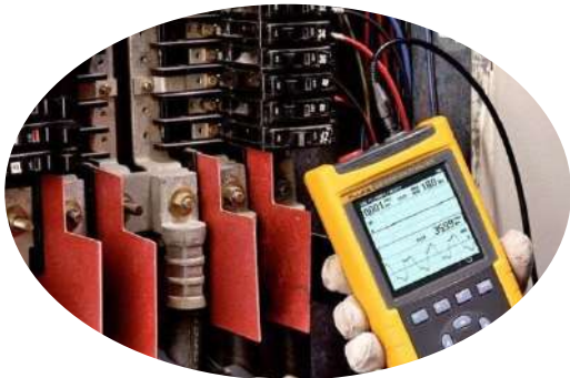
Medición de energía
